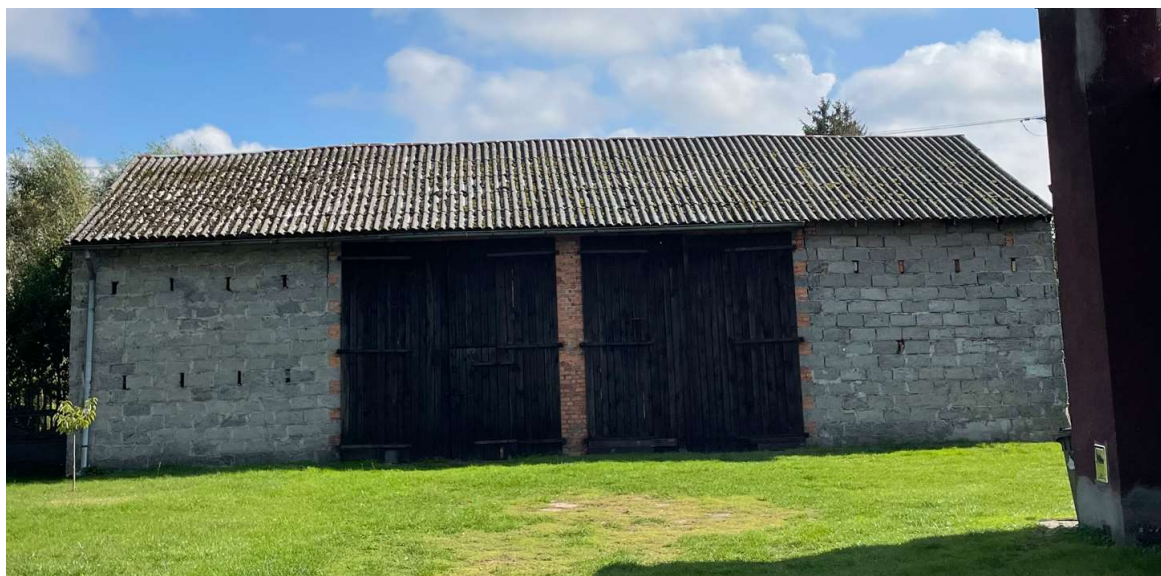
Rysunek 9 Pokrycie dachowe budynku gospodarczego wykonane z płyt falistych azbestowo – cementowych zakwalifikowane jako III stopień pilności.
