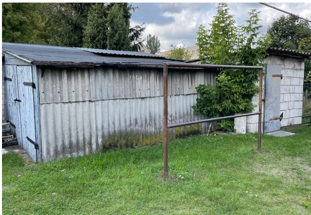
Rysunek 8 Elewacja i częściowe pokrycie dachu garażu wykonane z płyt falistych azbestowo – cementowych zakwalifikowane jako II stopień pilności.
